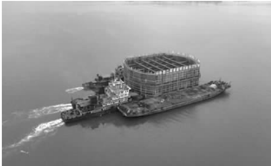
东环线控制性工程明月峡长江大桥的钢围堰前日顺利下沉
